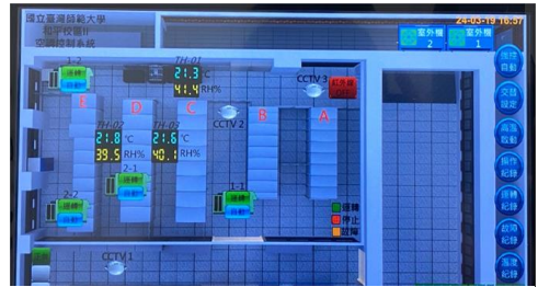
和平校區機房空調運作即時狀態畫面
